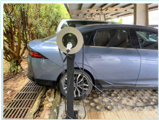
安装运营新能源车辆充电桩
